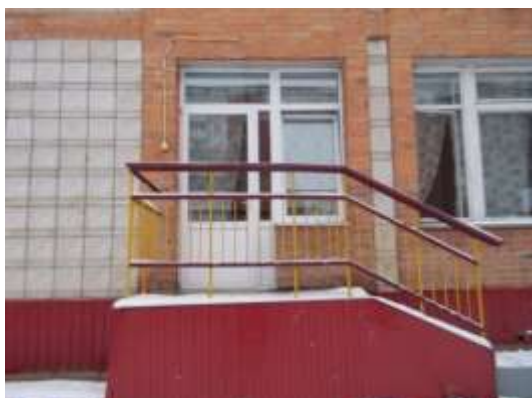
Фото №5 запасной выход с группы 1-этаж
