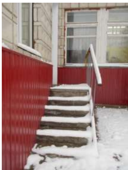
Фото №13 Запасной выход с группы 1-этаж
