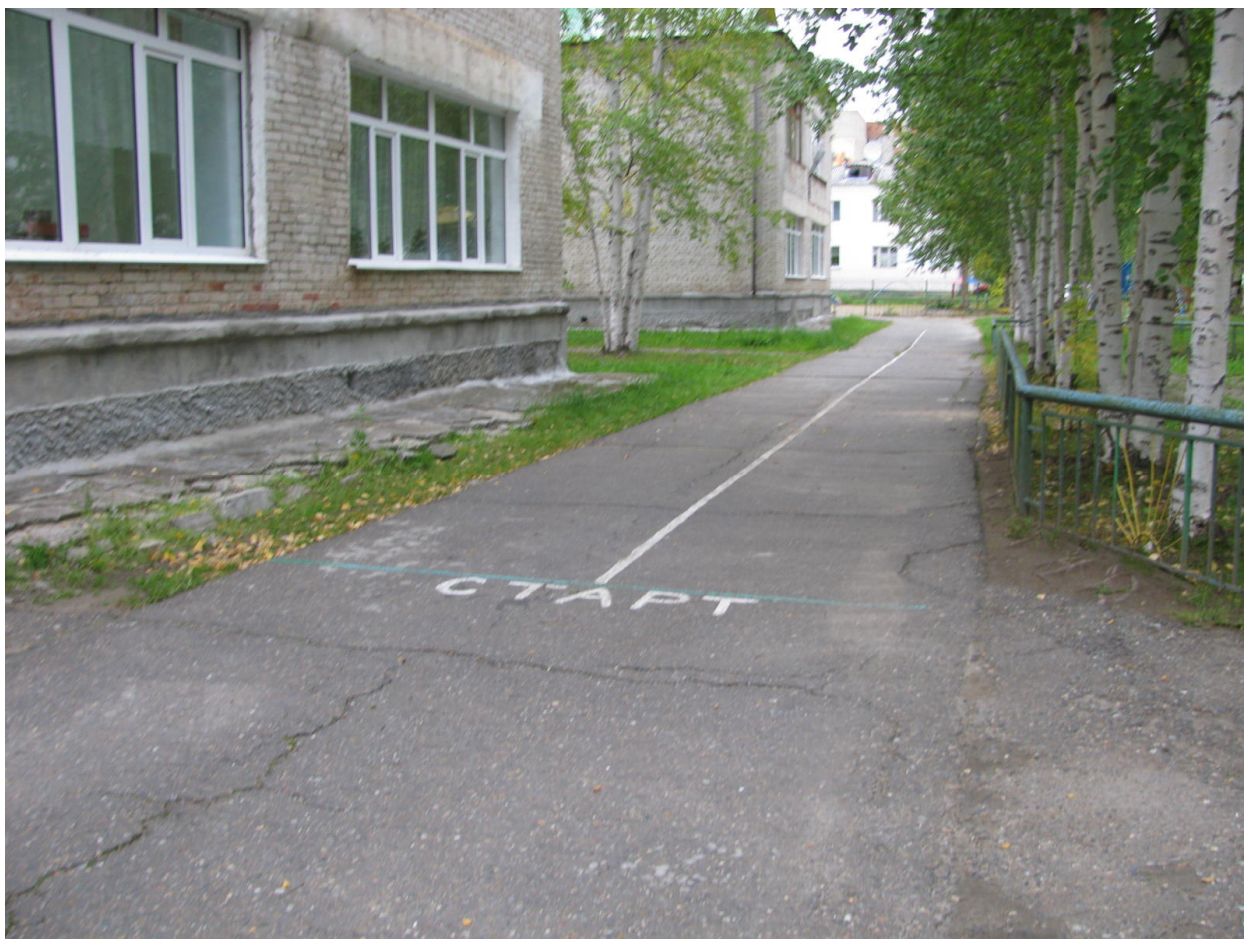
Фото 12 – Территория, прилегающая к зданию. Асфальт с неровностями и выбоинами.
