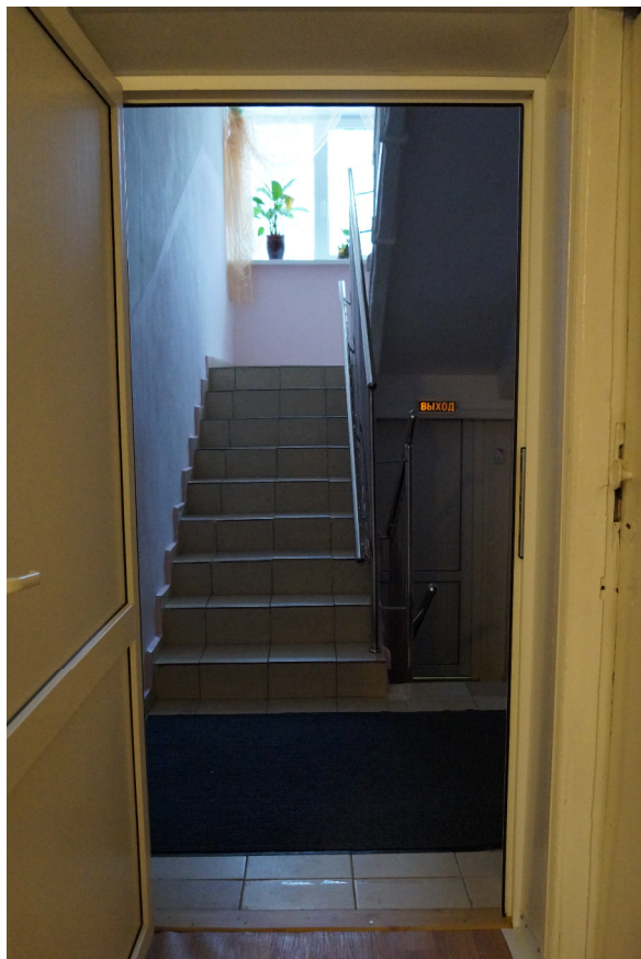
Фото 22 – Дверные проемы расширены: вход №2, вход в коридор 1 этажа и в групповом помещении гр. «Улыбка».
