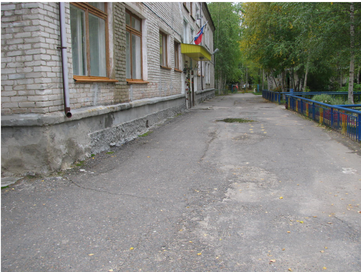
Фото 10 – Территория, прилегающая к зданию. Асфальт с неровностями, выбоинами.
