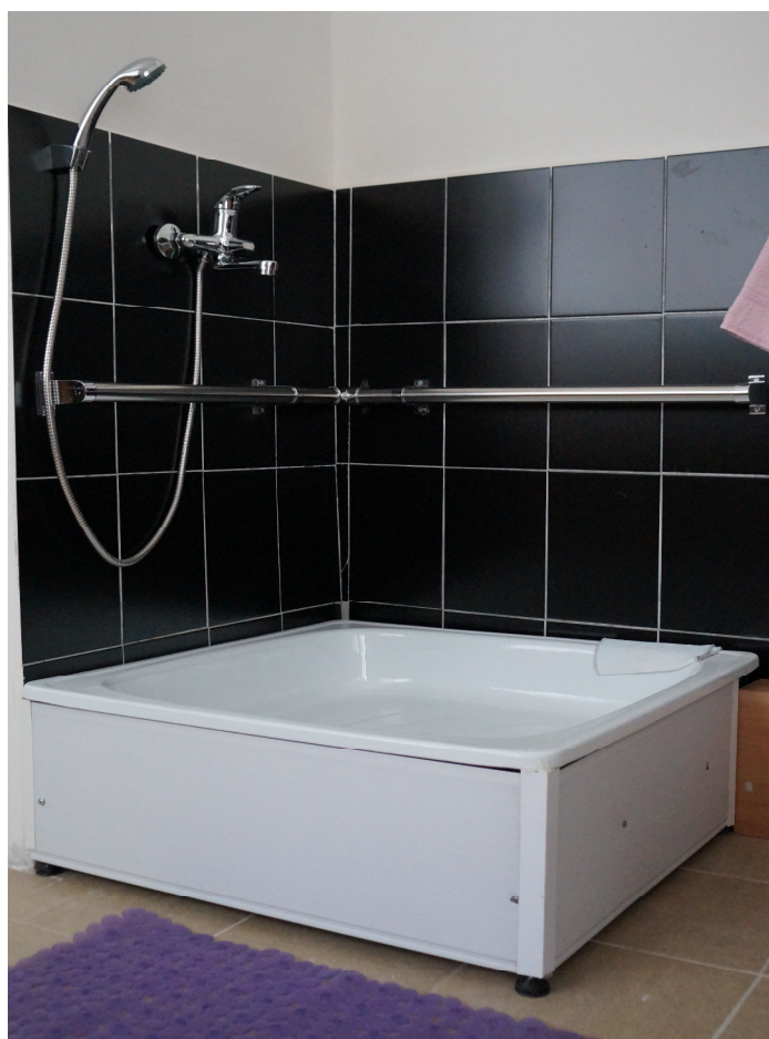
Фото 25 – Душевой поддон оборудован поручнями.
