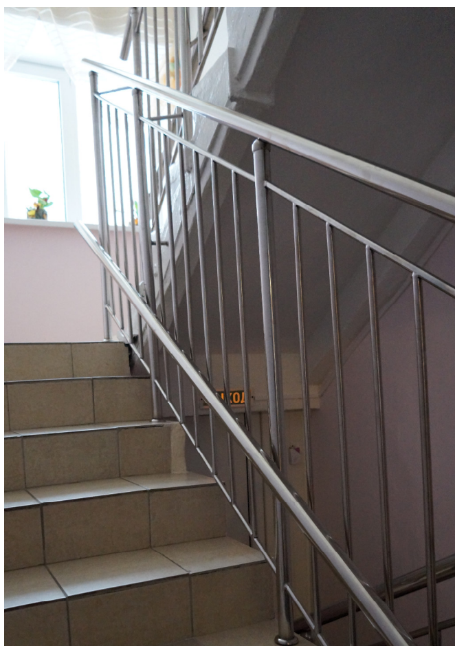
Фото 19 – Лестничный пролет входа №1, ведущий на 2 этаж, оборудован ограждением и поручнями.
